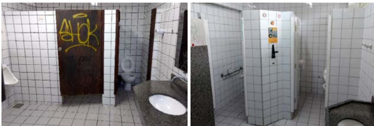
Figura 11: Banheiros no prédio do Cemuni IV (à esquerda) e IC II (à direita), cujas instalações já não atendem à demanda existente, não sendo possível a instalação de um chuveiro.
